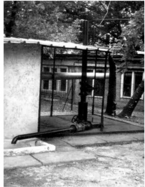
A Tétényi úti hévízkút 1972. decemberében kialakított és 1995. szeptemberében elbontott kútfej-kiképzése (1989. évi állapot)
